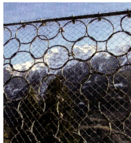
リングネット落石防護柵
